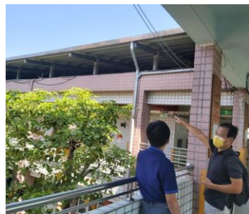
9/23 結構技師到校勘察 地震災損狀況
